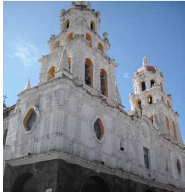
Argamasas en la fachada del templo de la Compañía de Jesús, Puebla de los Ángeles. Foto: José Antonio Terán Bonilla.
