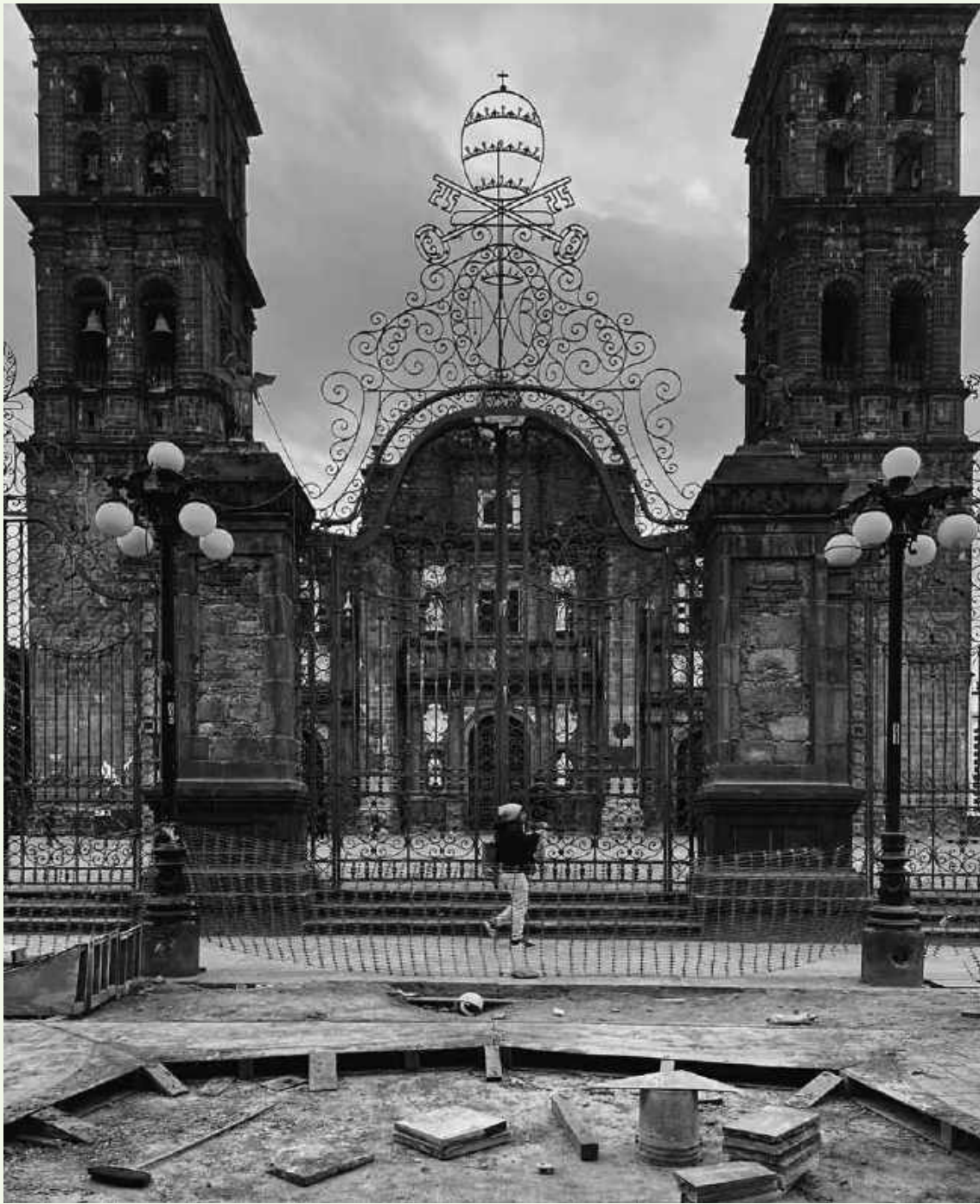
Vista de la Basílica Catedral de Puebla y el proceso de la obra. 2023. Foto cortesía de la autora.
