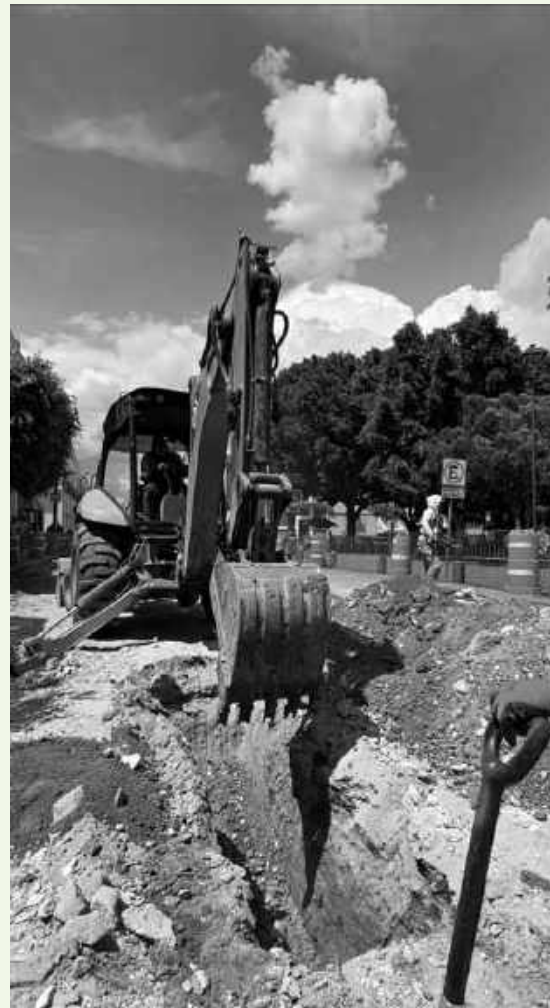
Proceso de la obra de mejoramiento de la imagen urbana de la calle 16 de Septiembre. 2023. Foto cortesía de la autora.
