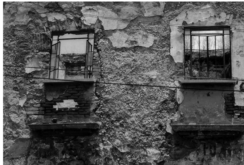
Vista de fachada deteriorada en el Centro Histórico de Puebla. 2022. Foto de Claudia Castelán.
