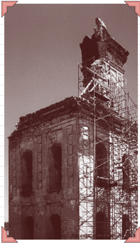
Templo de San Agustín. Foto tomada desde la Bóveda principal de la Torre, fachada lateral surponiente. Se observan trabajos de habilitado de andamios, retiro de aplanados sobre los muros y arcos. Así como apuntalamiento y aseguramientos de elementos estructurales con fracturas, (1999). Juan Campos de la Cruz.
