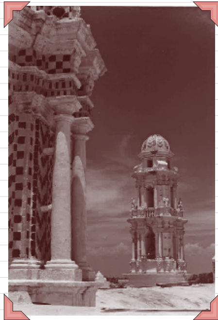
Templo de la Soledad. Foto tomada desde la fachada lateral norte de la cúpula, de la torre fachada nororiente. Se observan deterioros como: colapso del remate o cruz, desprendimientos de aplanados en cornisas y fractura de pilastras y arcos de los cuerpos de la torre, (1999). Juan Campos de la Cruz.
