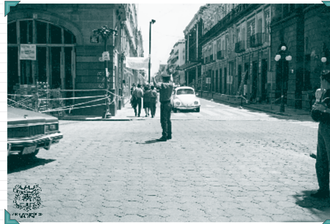
Vista del Palacio Municipal y Museo Universitario (Casa de los Muñecos), apuntalados sus edificios, debido a los daños causados por el sismo de junio de 1999. AGMCP- Material fotográfico, MCMT-2403, 1999-2002.
