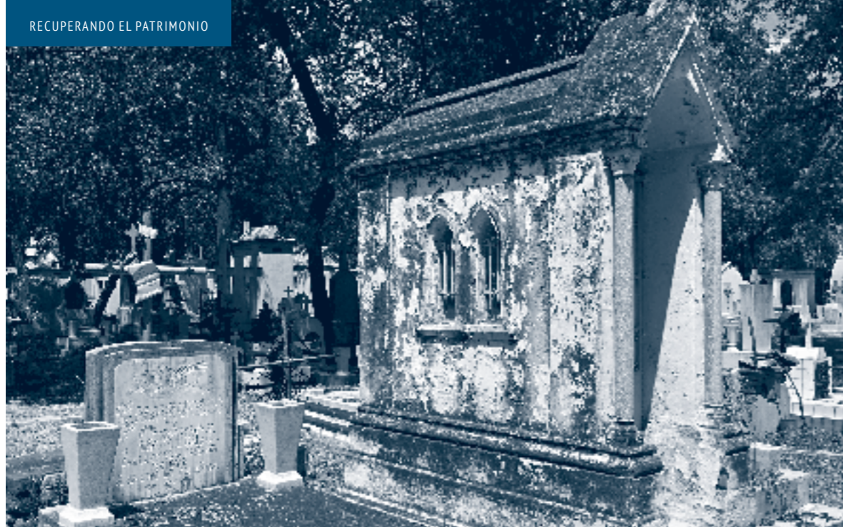
Deterioro de monumentos funerarios. Panteón Municipal. 2020.
