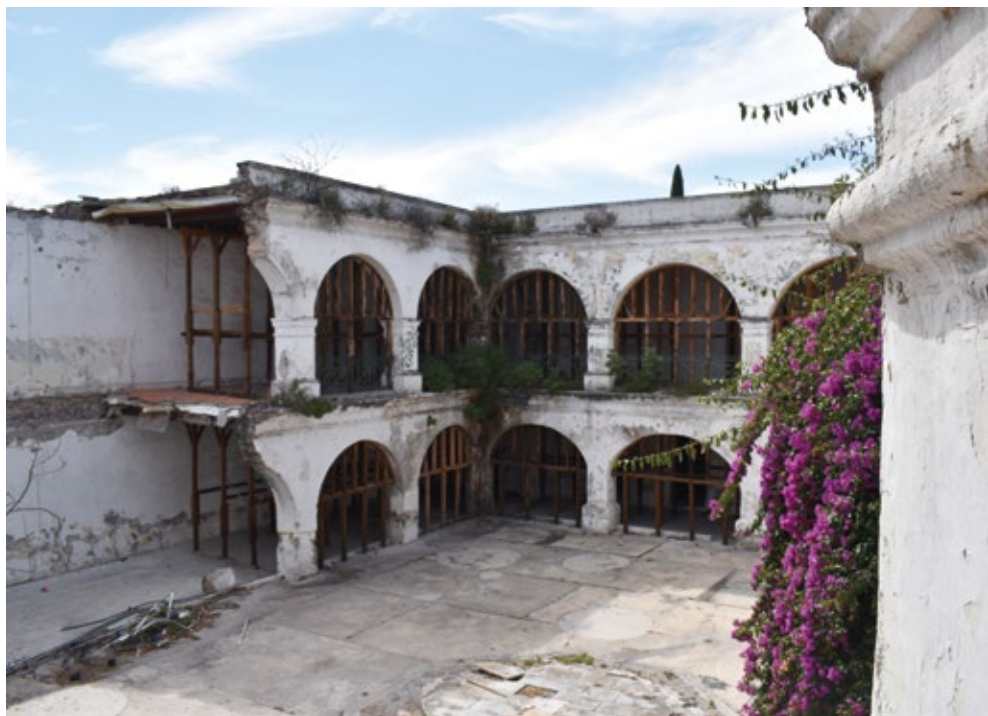
Foto 2. Estado inicial del Ex Hospital
