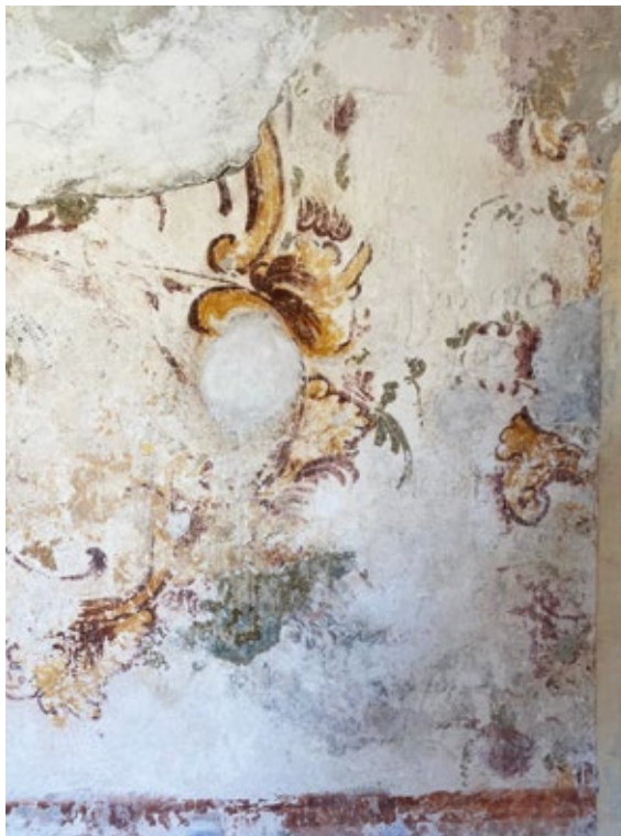
Foto 12. Detalle de pintura mural antes de proceso
