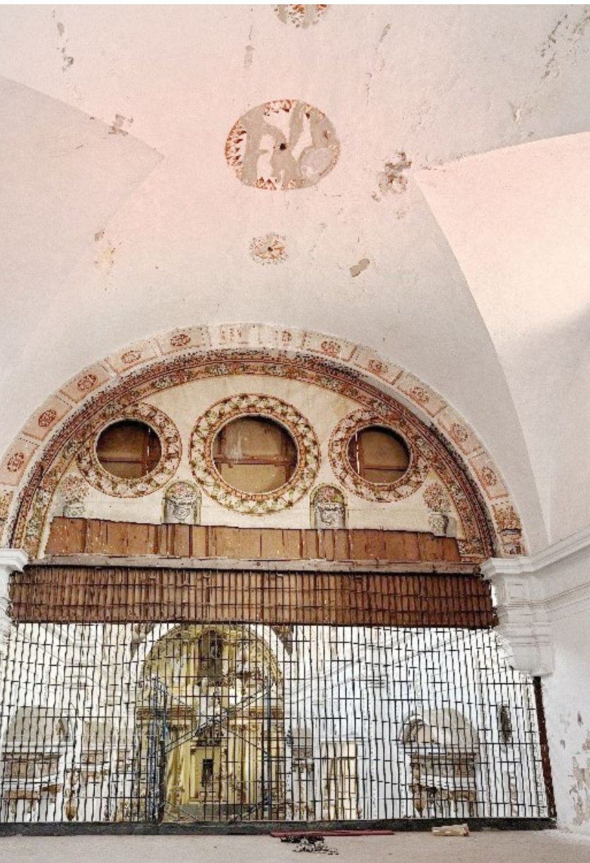
Imagen 4. Bóveda de lunetos del coro con presencia de pintura mural en paramentos, se observan grietas y fisuras, desprendimiento de pintura. Al fondo se aprecia el cancel de clausura fabricado a base forja. (GPX S.A de C.V., 2025)
