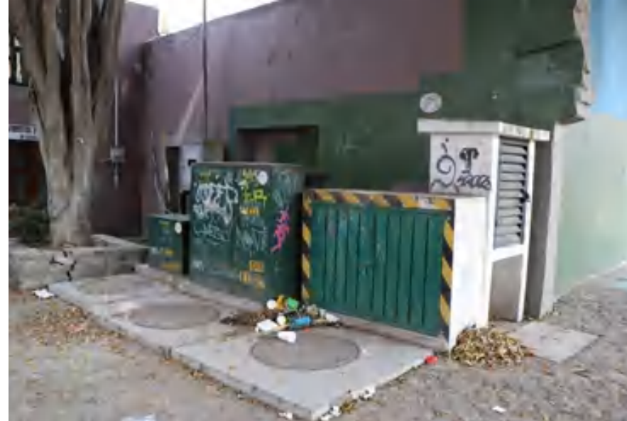
Cajas de electricidad en el Parque de Xanenetla
